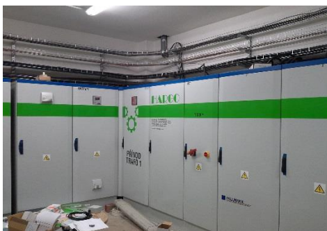
Obrázek 6: Průmyslová rozvodna – rozvaděče uspořádané do písmene „L“
