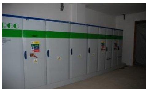
Obrázek 5: Průmyslová rozvodna – rozvaděče postavené v řadě
