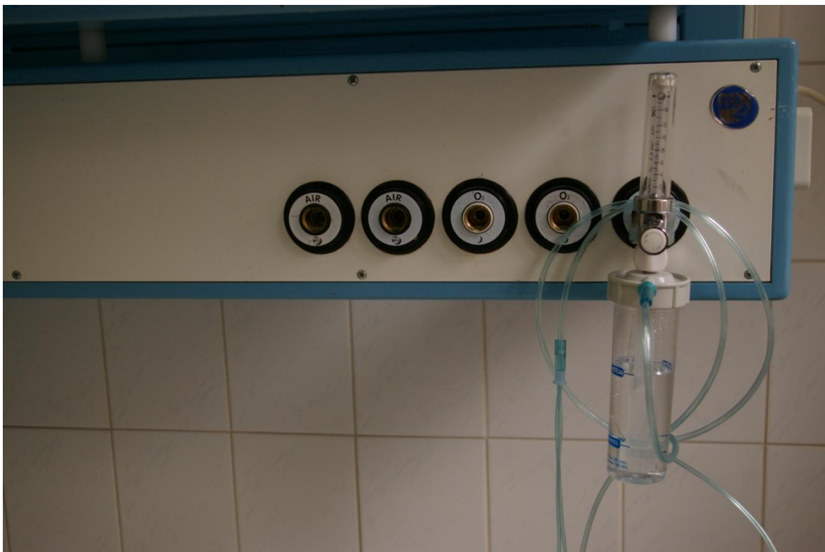
Příloha 6 – Rampa s rychlospojkami vývodů plynů a průtokoměrem s nádobou
