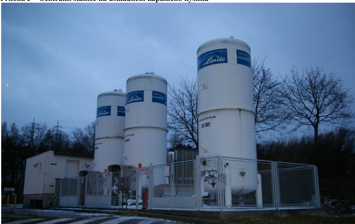
Příloha 5 – Centrální stanice na uskladnění kapalného kyslíku
