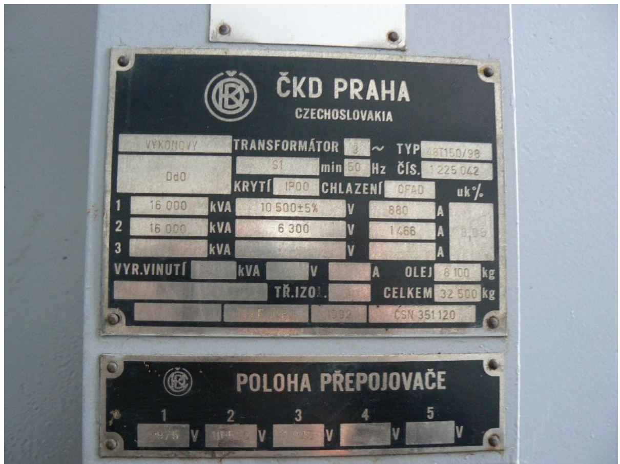
Obr. 2.12 Štítek transformátoru 63BBT09
