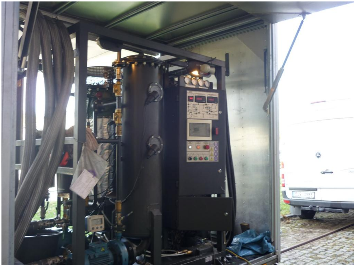
Obr. 2.16 Filtrační stanice pro ohřev oleje
