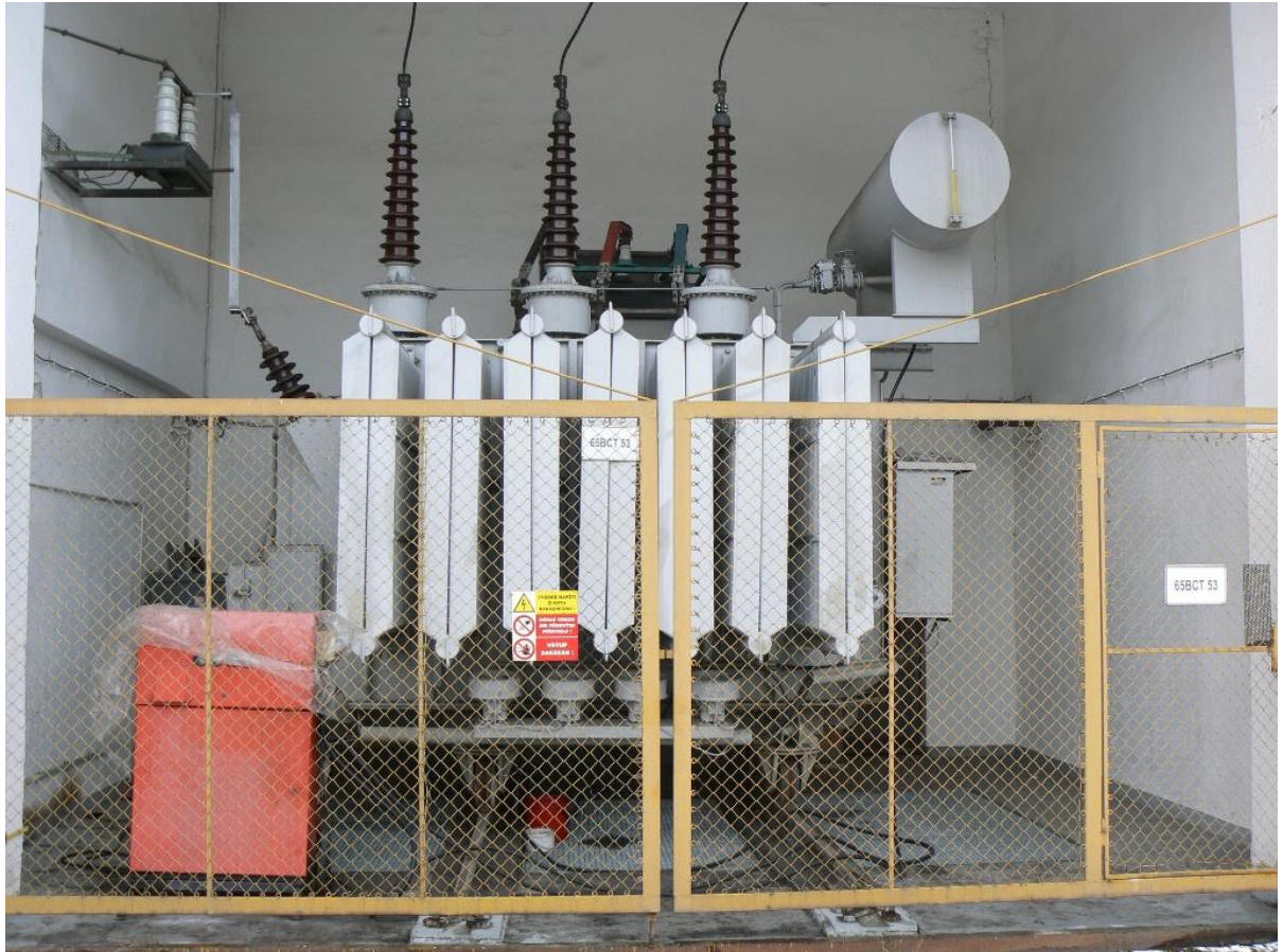
Obr. 2.4 Transformátor 65BCT53 na pozici v kobce
