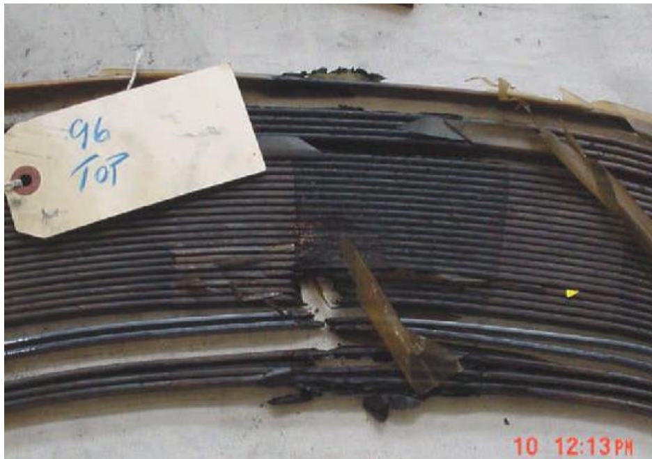
Obr. 1.5 Havarijní důsledek přítomnosti korozivní síry v izolačním oleji transformátoru (převzato z [10])
